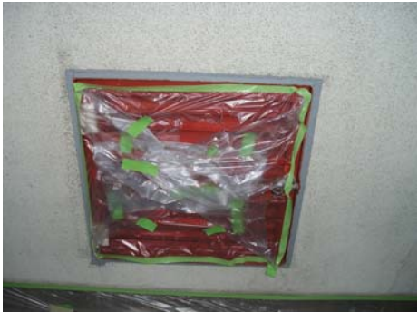
CF式風呂釜給気口をビニールで覆った例 《このような状態では、不完全燃焼による一酸化炭素中毒が発生する可能性あり》
