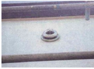
FF式給湯器排気トップの例（集合住宅外壁面） 《養生の際に塞がれると、異常着火や不完全燃焼の可能性あり》
