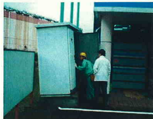
【地震で移動したキュービクル】 (資料提供：(財)東北電気保安協会)
